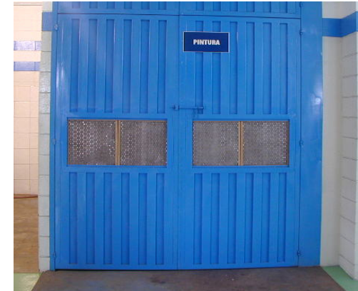
CABINE DE PINTURA (Sistema Filtro Seco)
