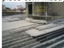
- Motivos dos vazamentos - Paredes do telhado com infiltrações e mofos Telhado com remendos de cacos de telhas e telhas quebradas
